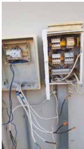
Quadri elettrici: Prima
