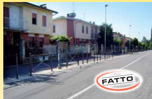
«Messa in sicurezza di via Zanardelli, con barriere protettive per la pista ciclo-pedonale»
